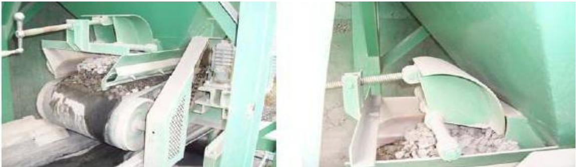
<그림 5.3> VS모터 방식의 컨베이어 피더와 콜드빈 게이트 높이조절 장치 전경
